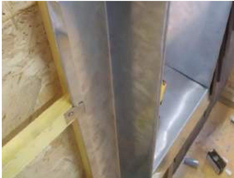
Photographie 5 : Traitement des couloirs latéraux avec pattes de fixation. Les couloirs latéraux sont raccordés avec la bavette basse par recouvrement afin d'évacuer l'eau.
