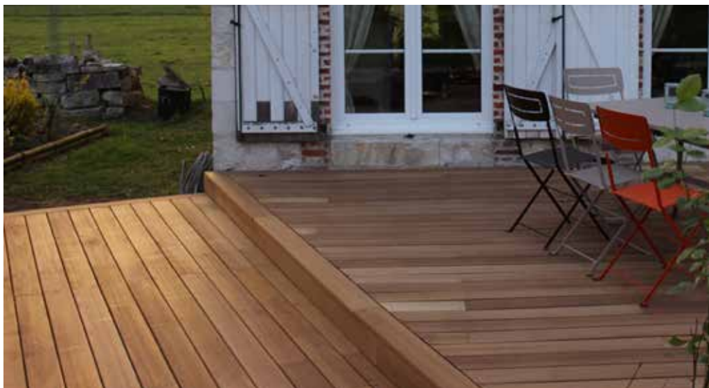
Terrasse en peuplier THT au moment de la pose. ENTREPRISE BOIS : CENTRE BOIS MASSIF (18)
