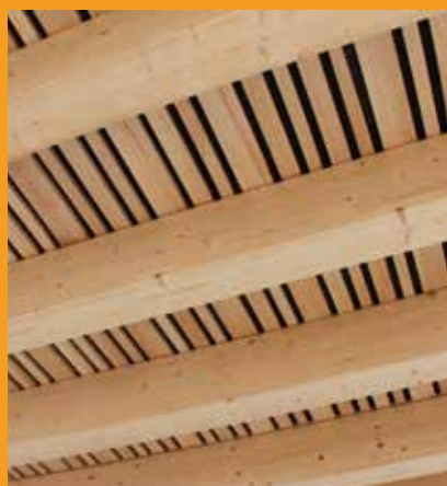
Caissons de sous-face de plancher à la DDTM de Vannes (56). ARCHITECTE : AIA ARCHITECTES (44), TRAITEMENT BOIS : WOODENHA (44)
