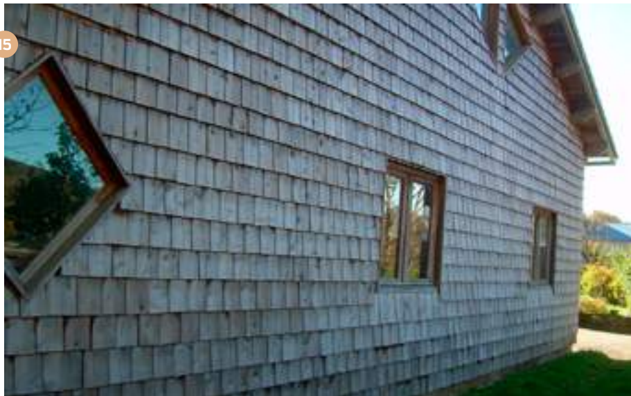
15 - Maison individuelle couverte de tavaillons en mélèze ©Scierie Mobile du Haut Languedoc
