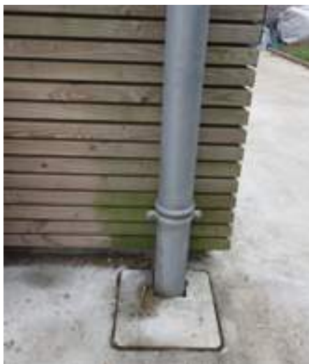
Développement de mousse au pied d'une évacuation d'eaux pluviales indiquant une zone d'humidité
