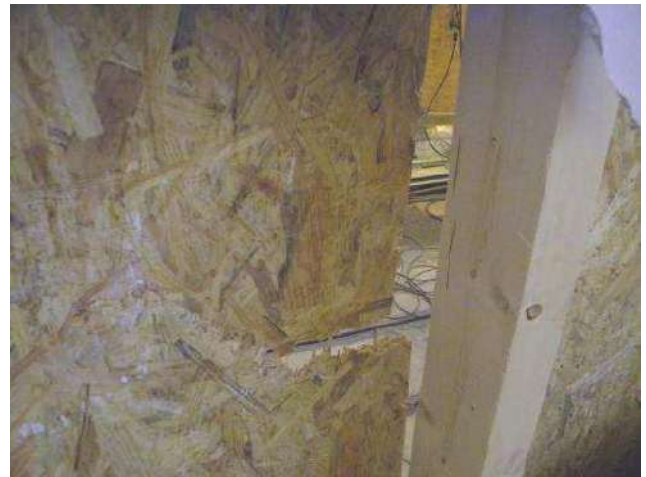
Photo 2 : Rupture du panneau de contreventement suite à un choc à 900 J
