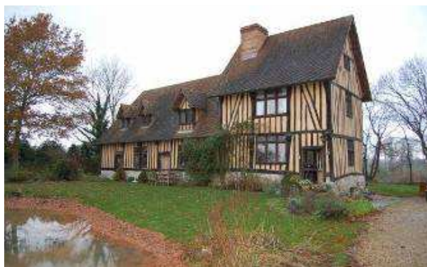
Manoir Cauchois à Saint Amoult particulièrement bien restauré : il conserve un intérêt patrimonial fort. Un enduit épais chaux-chanvre a été mis en place, améliorant le confort thermique et réduisant les infiltrations d'air.
