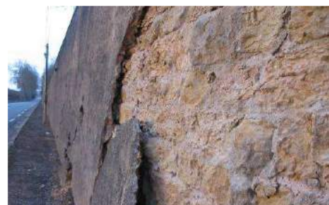
Décollement d'un enduit ciment
