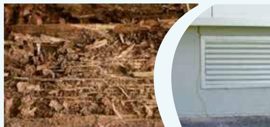
Dégâts de termites sur du bois de chauffage stocké au sol
