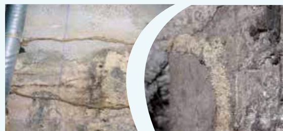
Cordons de termites sur un mur de cave
