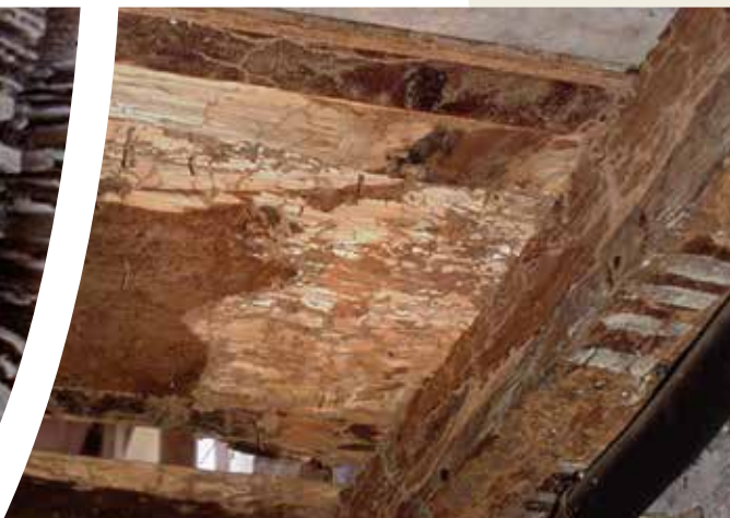
Attaques sur un solivage de plancher
