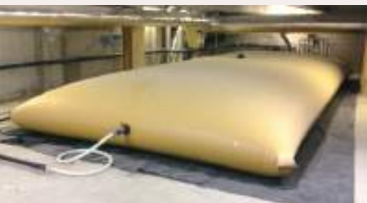
Cuve de 80 m 3 installée pour la récupération des EP sur le plancher existant du R+3.
