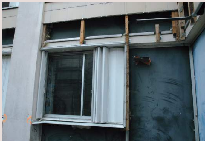
Panneaux de façade menuisés avec châssis aluminium et allège en panneaux amiante-ciment de 35 mm, posés entre dalles et poteaux béton.
