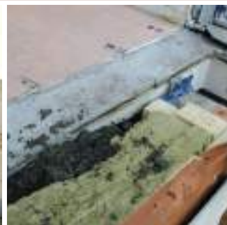
Le béton vient combler la réservation entre la laine de roche et la dalle existante. L'emprise de l'ancienne façade est à ce stade visible.
