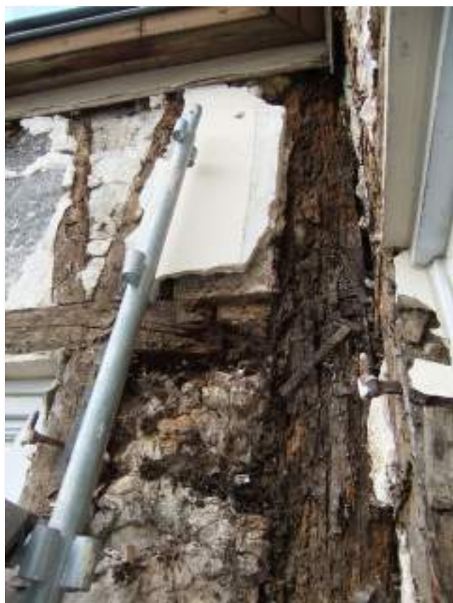
Façade d'un bâtiment en colombages vu en 2010 après piquetage d'un enduit ciment : les bois sont très dégradés car le ciment n'est pas adapté à ce bâti ancien.
