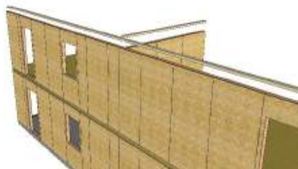
Figure 22 – Mise en œuvre des lisses sablières de chaînage, vissées sur les traverses hautes en tête de panneau de mur
